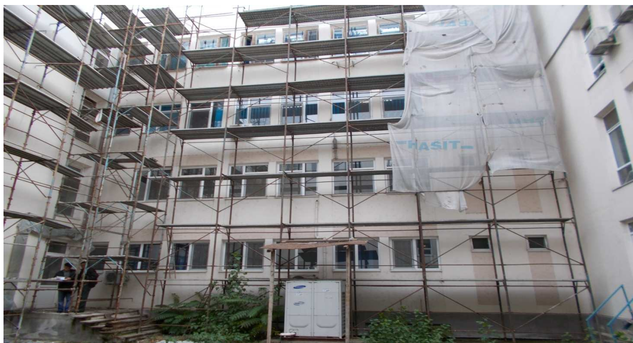
C4 - Fatada N in curte interioara C4,C5,C6 si C7( se observa instalatia de climatizare)
