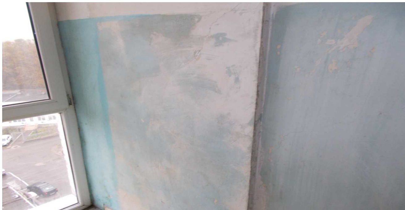
C1 – Pereti deteriorati pe casa scarii
