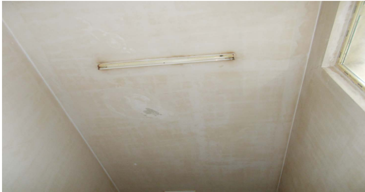
C1 - Corpuri de iluminat deteriorate si defecte
