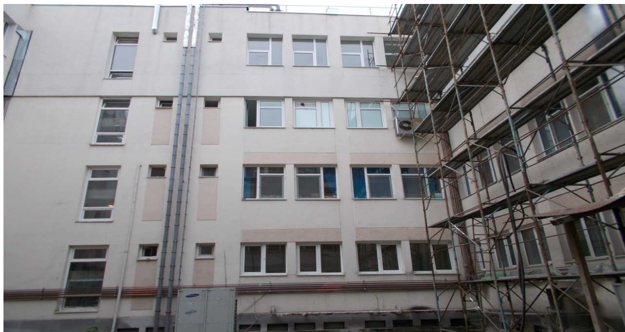
C6 - Fatada N in curte interioara C4, C5, C6 si C7( se observa instalatia de climatizare)
