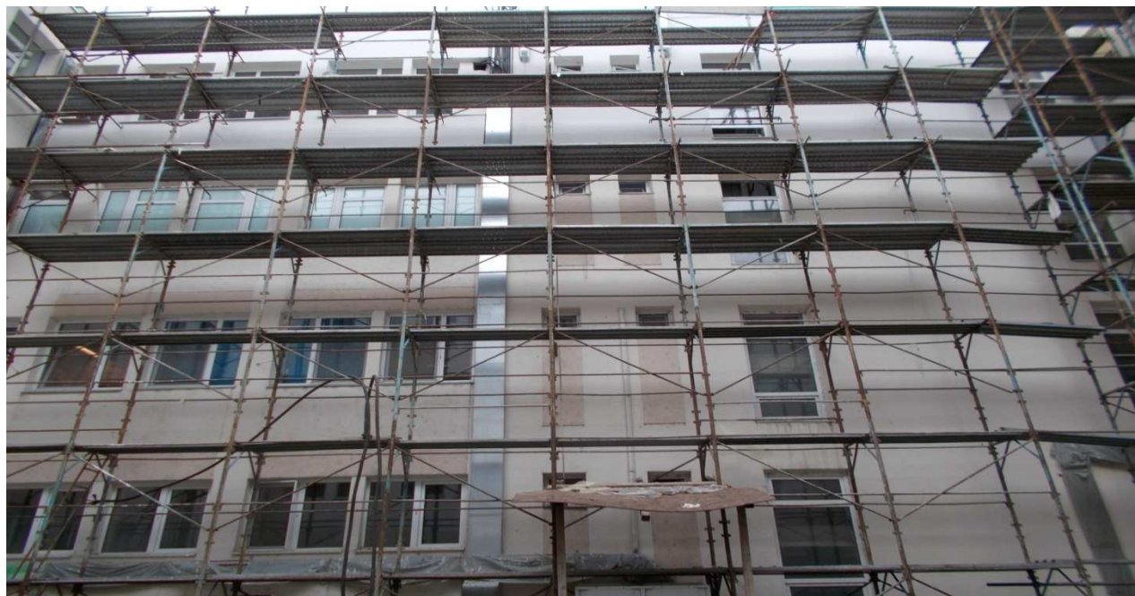
C7 - Fatada N in curte interioara C4,C5,C6 si C7( se observa instalatia de climatizare)
