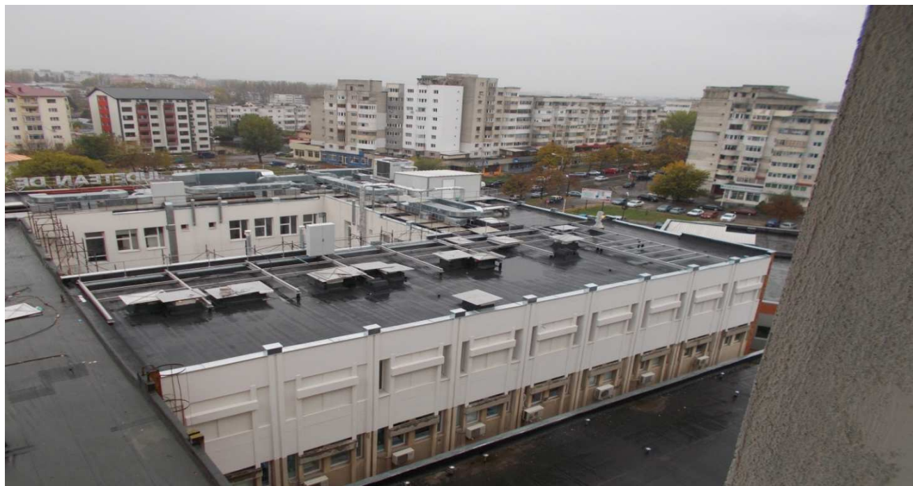
C4,C5,C6,C7 - Plansee terasa necirculabila si instalatii de climatizare si ventilatie
