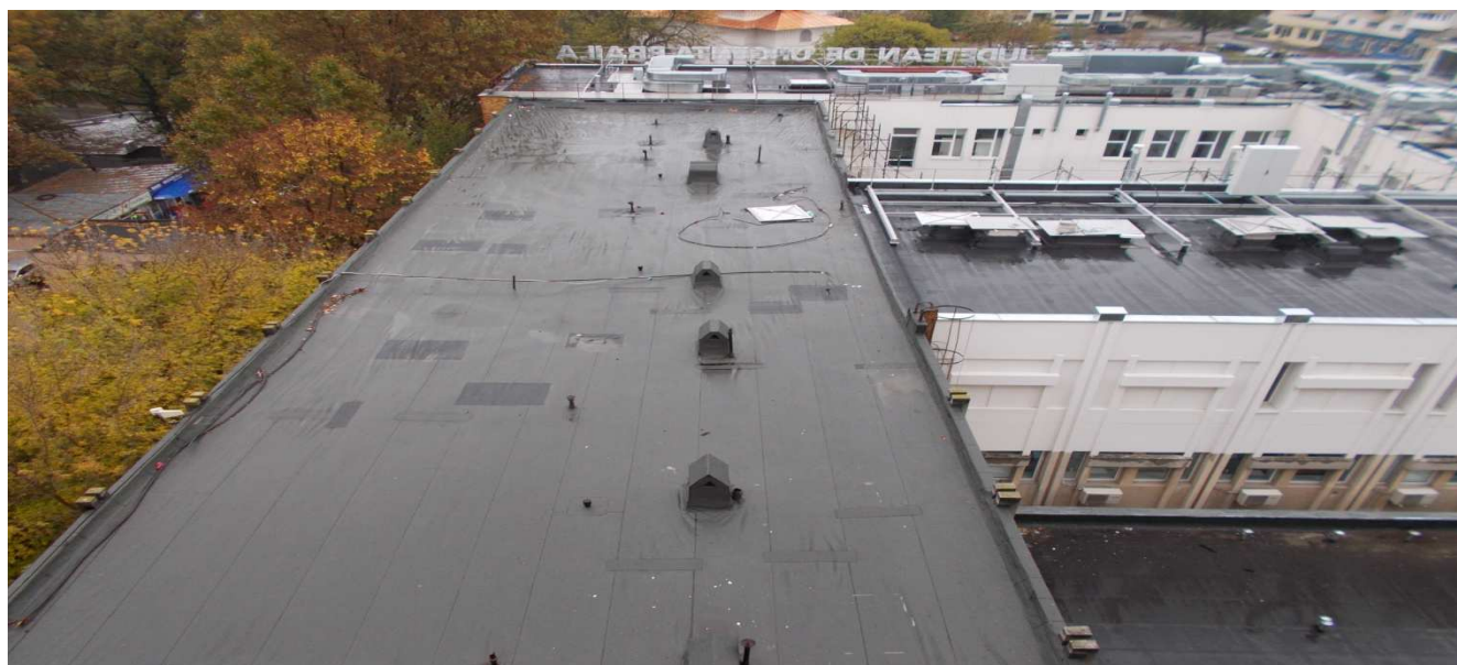
C4,C5,C7 - Plansee terasa necirculabila si instalatii de cimatizare si ventilatie
