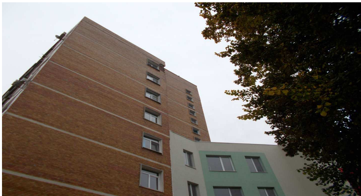
C3 – Fatada N(in zona planseului superior tencuiala cazuta datorita infiltratiei de apa)
