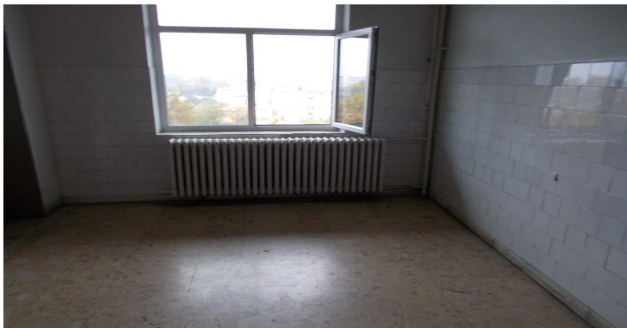
C1 – Hol din zona lifturi, incalzit cu calorifere de fonta
